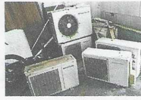
ares condicionados gerais
