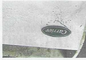
ar condicionado Carrier com marca
